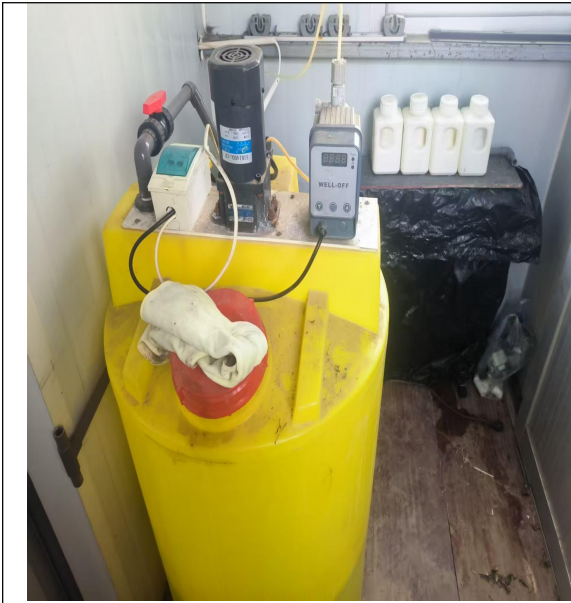
加药罐现场照片
